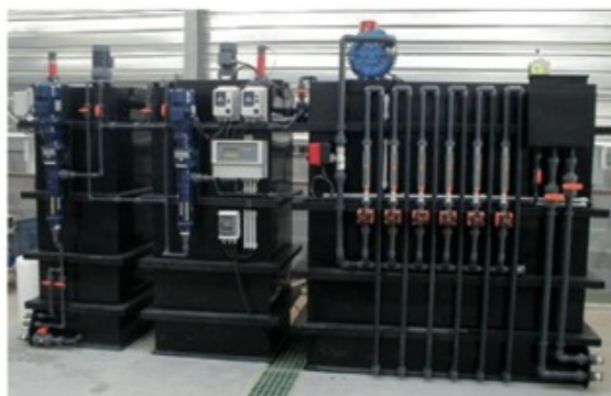
STATION DE TRAITEMENT D'EAU DE REJET
