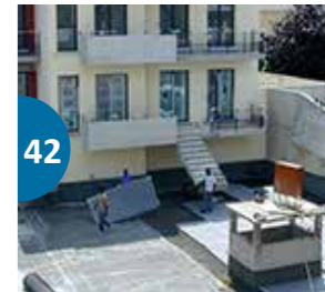
Stockage des eaux pluviales en toiture
