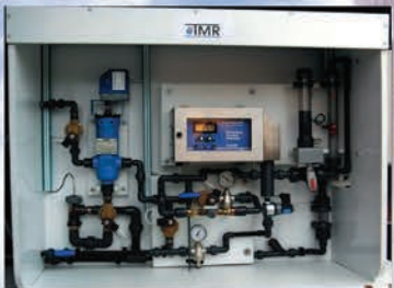
Régulation de l'apport de coagulant/floculant sur eaux potables
